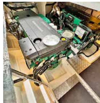
I det rymliga motorrummet finns gott om plats. Alla installationer är lätt åtkomliga.
