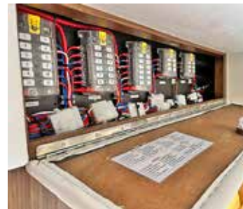
Föredömlig bra markering av alla elektriska installationer.
